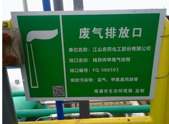
排气筒 FQ-506503 标识牌
