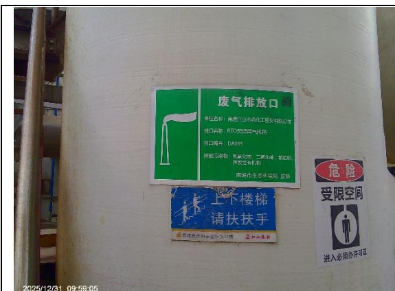
RTO 排气筒 (FQ-506473) 标识牌
