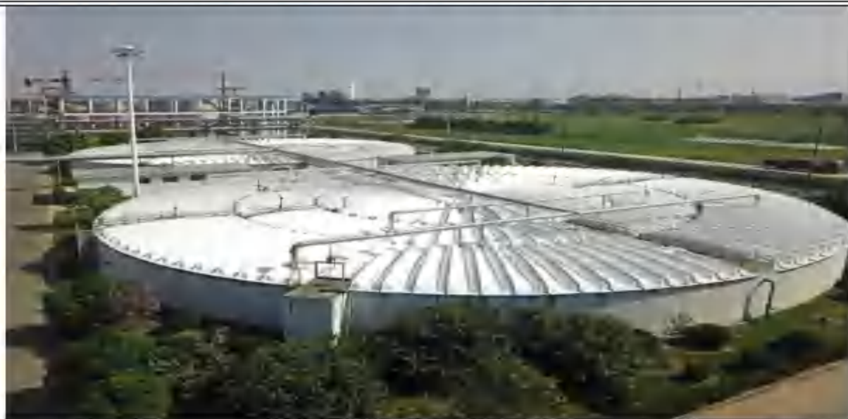
江山股份污水站-厌氧/兼氧/好氧池
