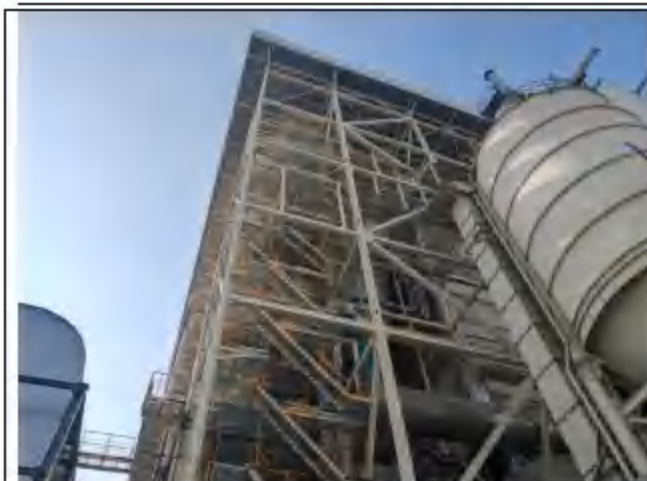
脱硫脱硝装置
