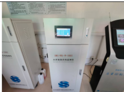
化水废水排口氨氮在线监测仪
