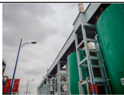
封闭式皮带廊道
