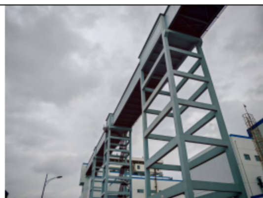
封闭式皮带廊道
