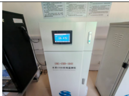
化水废水排口 COD 在线监测仪
