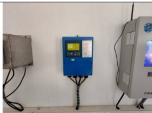
化水废水排口流量计
